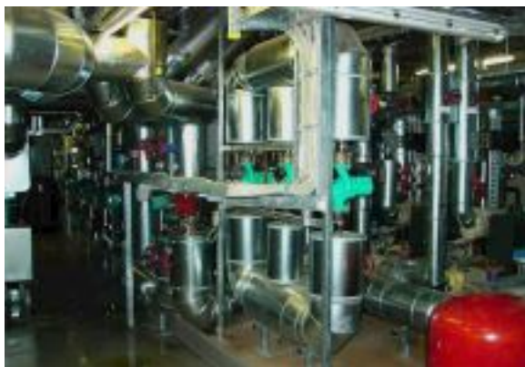
Rashladno postrojenje Medicinski institut Dizeldorf, Nemačka Zoom
